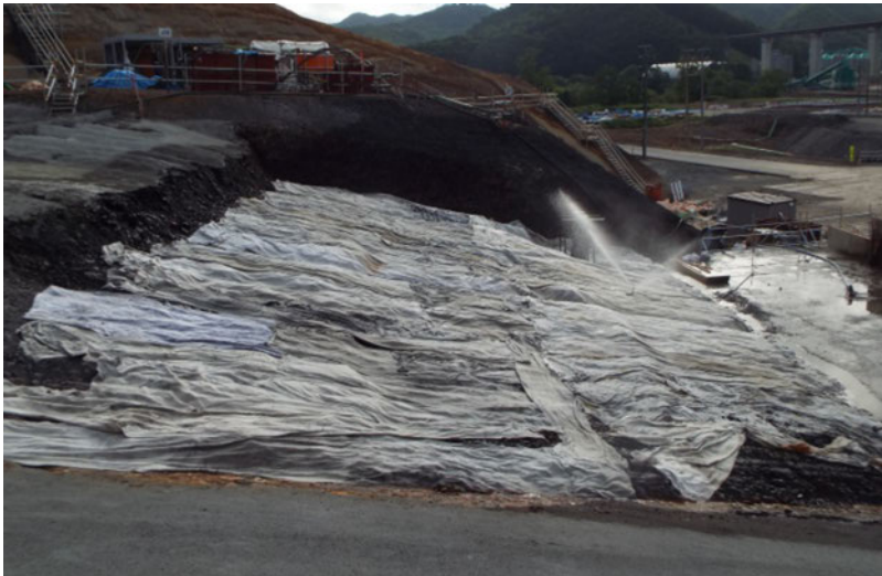
Fig. 15 Moisture mat curing of dam foundation Maturation par l'humidité de la fondation du barrage
