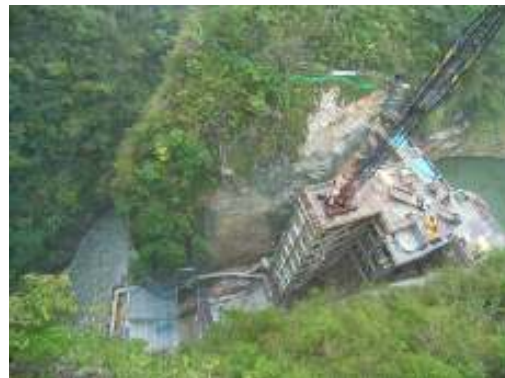
Fig.10 Steel-made temporary stage on the downstream of the dam Palier temporaire en acier en aval du barrage
